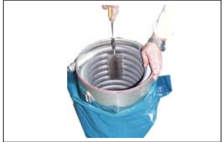
Fig: Limpiar intercambiador
