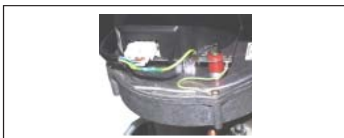
Figura: Linea d'alimentazione e messa a terra al ventilatore
