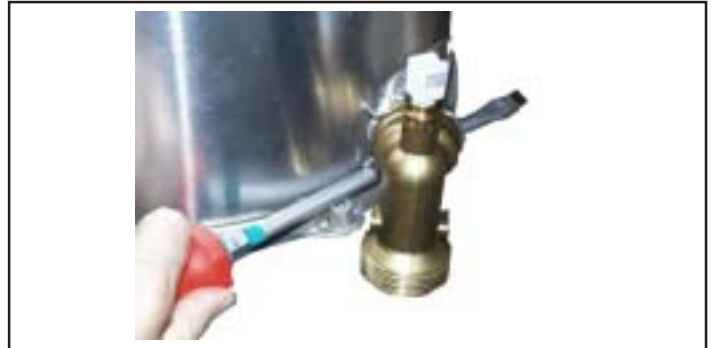
Fig: Soltar intercambiador de bandeja de condensados
